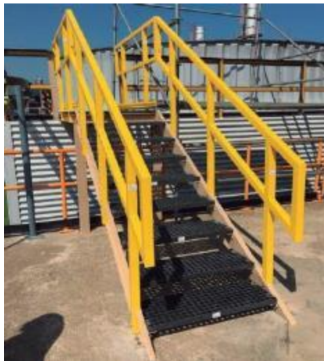
PLATAFORMA DE ACCESO A TORRES DE ENFRIAMIENTO
