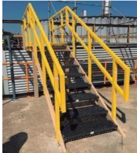
PLATAFORMA DE ACCESO A TORRES DE ENFRIAMIENTO
