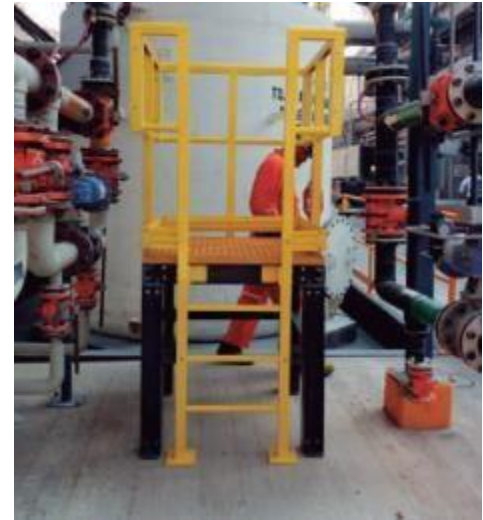
PLATAFORMA PARA ACCESO A VÁLVULAS
